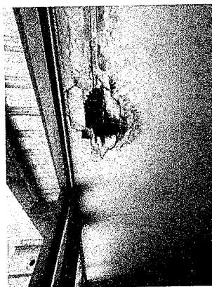
Afectación Cuarto Piso
